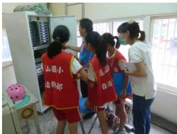
學習操作播音設備
