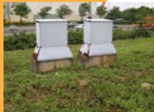
變電箱旁的蟻丘
