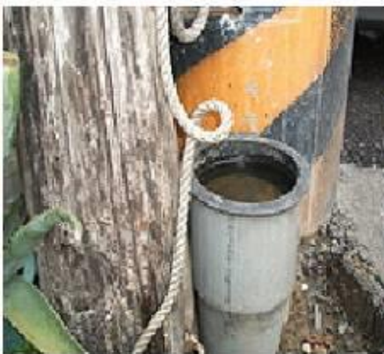
台電地下電纜引上管
