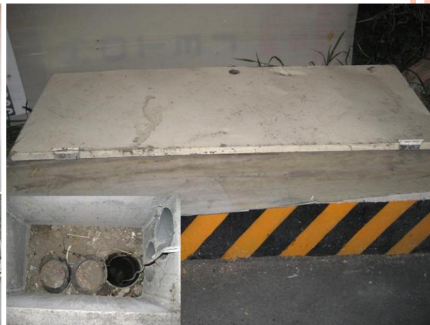
電信電纜管道
