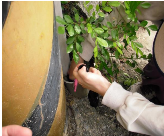
地下電纜引上管
