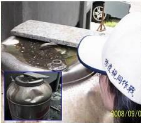
儲水桶鐵蓋凹陷處
