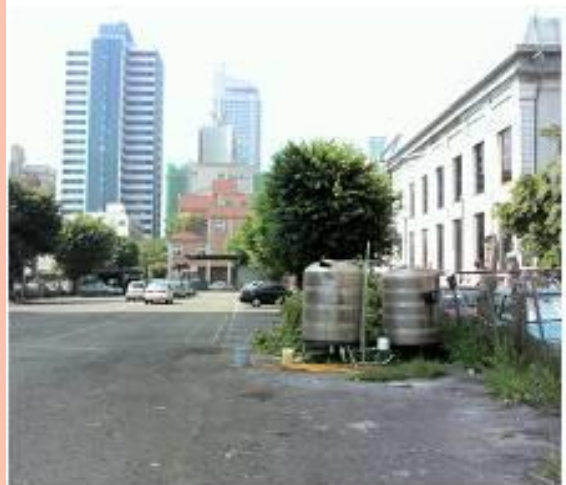
停車廠水塔無蓋
