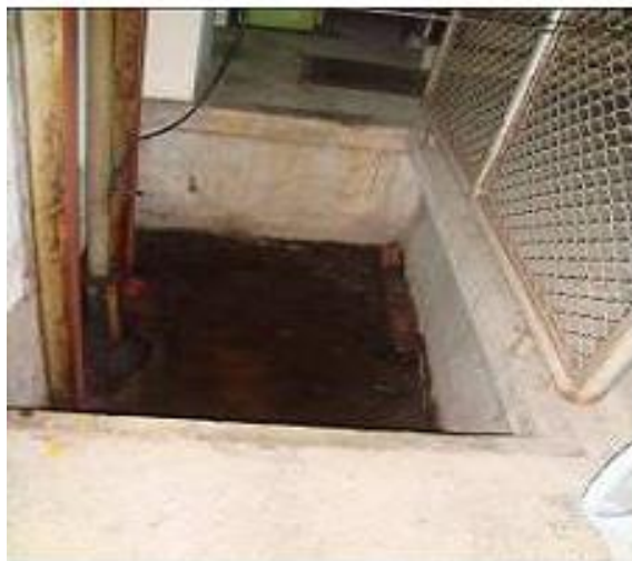
地下室之升降梯孔積水
